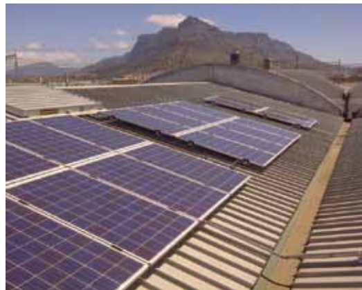
PHOTOVOLTAIK-ANLAGE zur Stromgewinnung auf dem Dach des PUMA Herstellers Impahla Clothing, Kapstadt, Südafrika.
