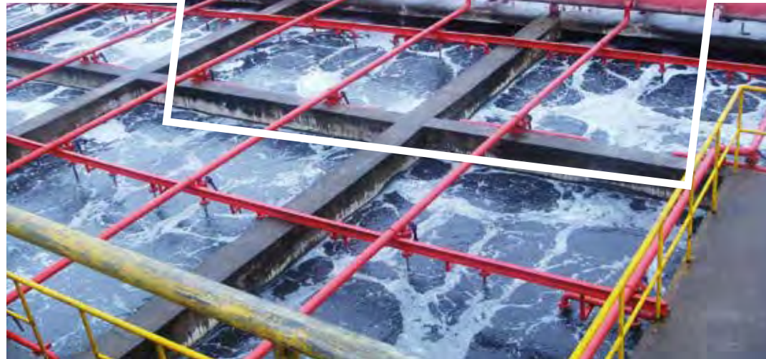
Das Bild zeigt den aeroben Prozess einer Abwasserbehandlungsanlage einer Färberei in China, die Textilien für PUMA Produkte herstellt
